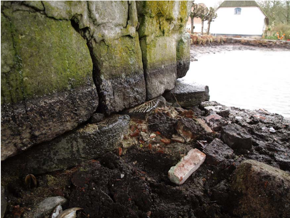
Tre møllesten brugt som fundament for den midterste bropille. De blev senere dækket med beton.
